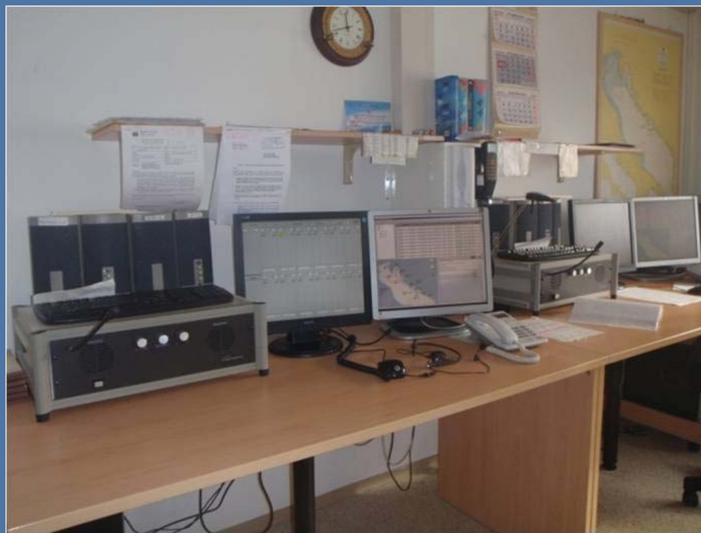
Obalna radijska postaja Split radio - operatorski pult za VHF sustav
